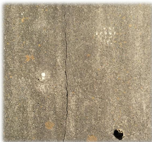
ひび割れ画像
