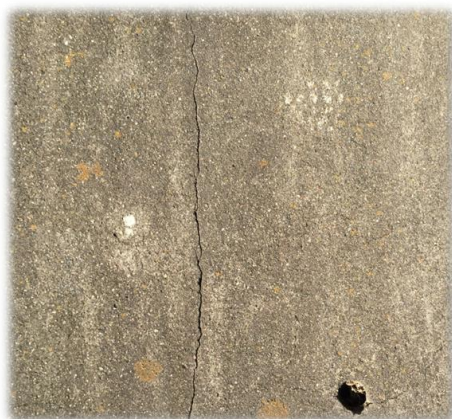
ひび割れ画像
